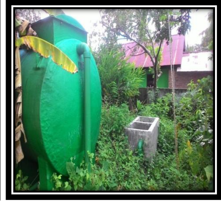
IPAL (Instalasi Pengolahan Air Limbah)
