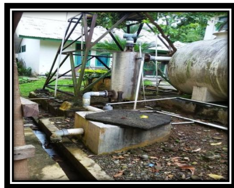
IPAL (Instalasi Pengolahan Air Limbah)
